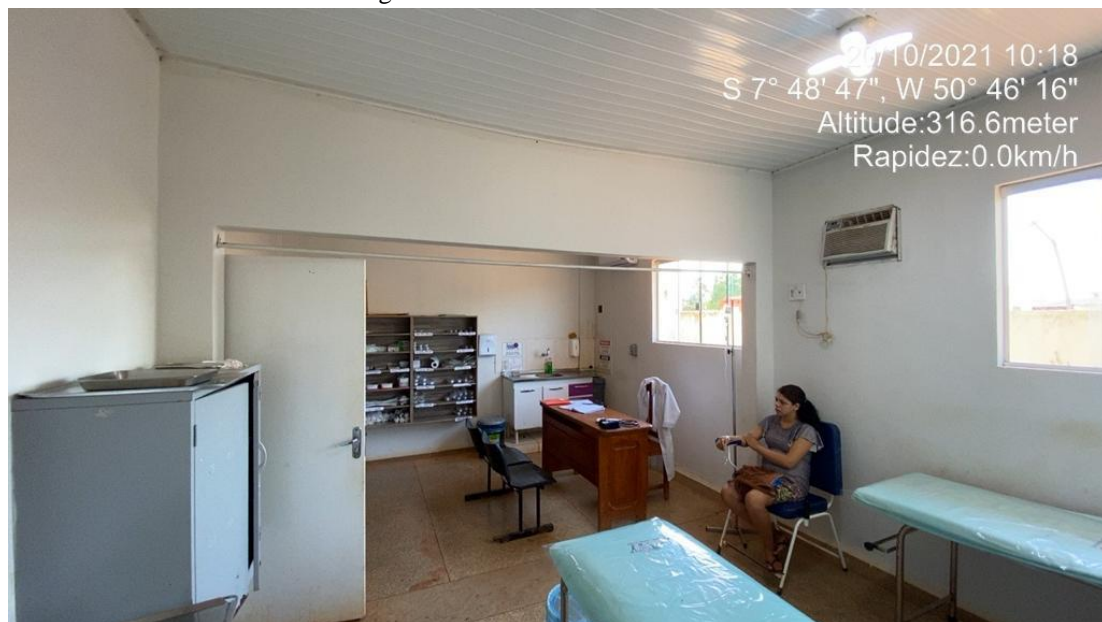
Imagens 15: Pintura Manchada.
