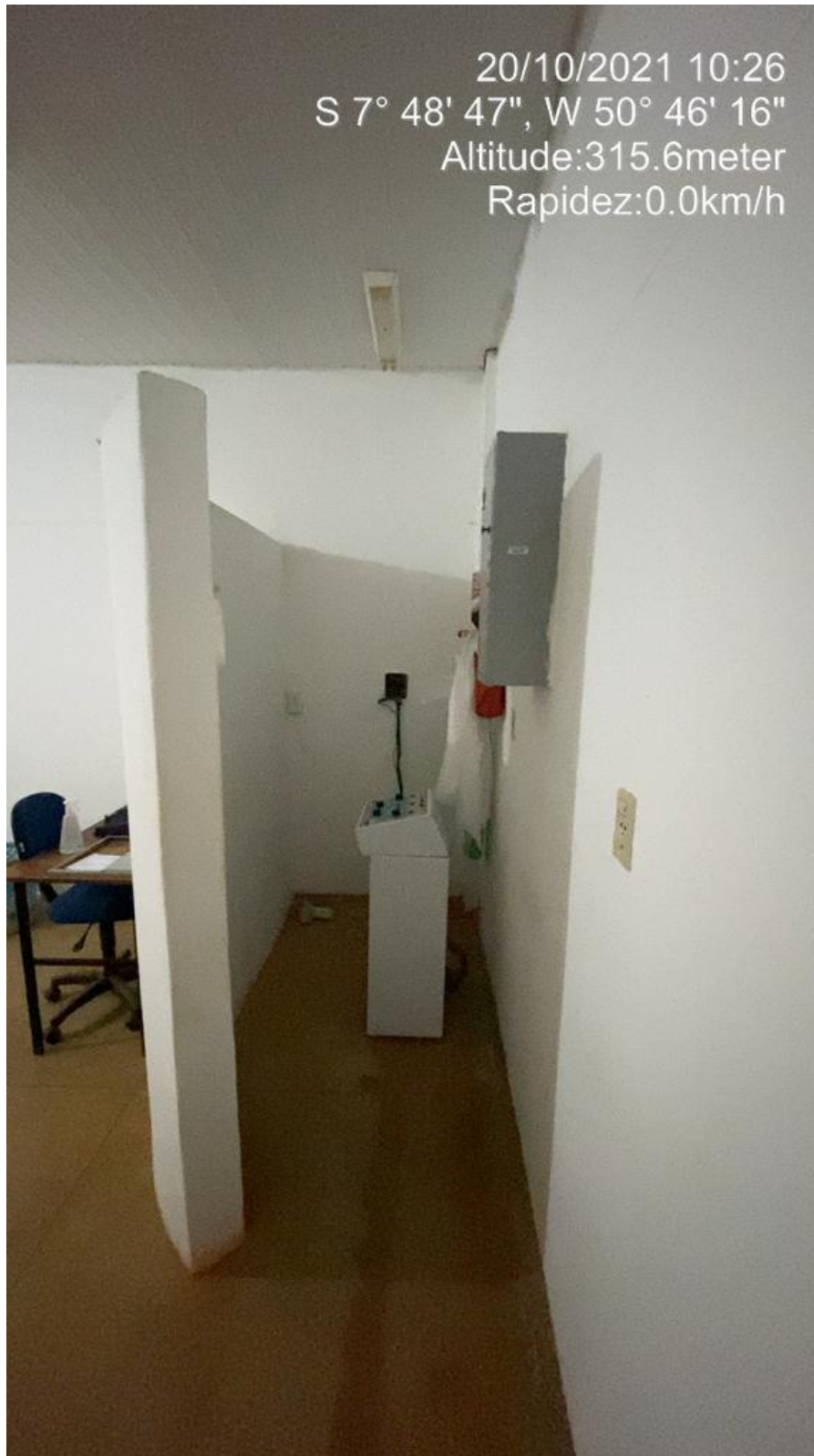
Imagens 35: Radiologia Piso Manchado.
