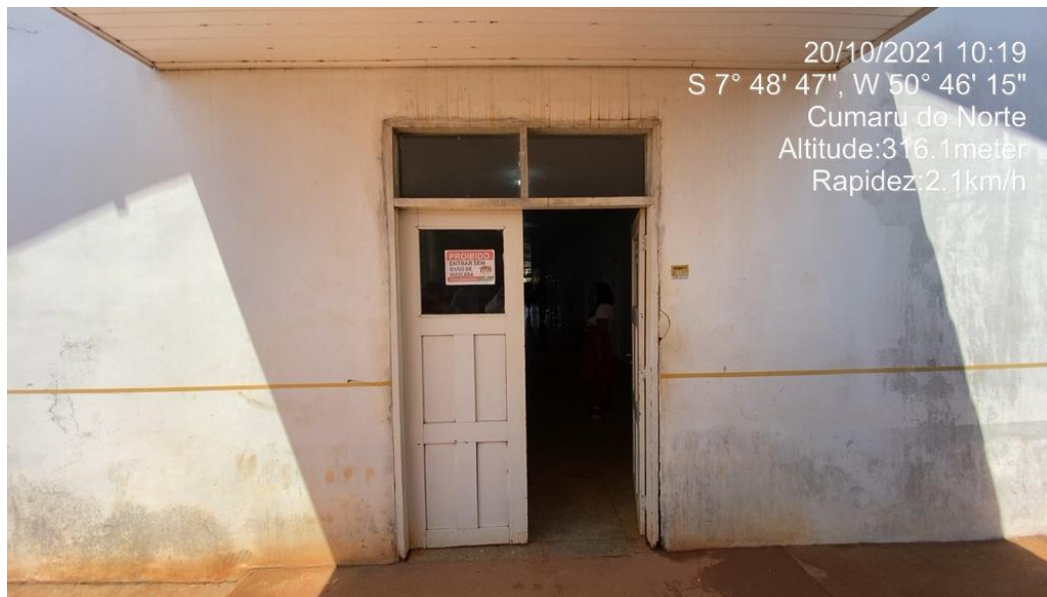
Imagem 19: Infiltração e Umidade na Parede.
