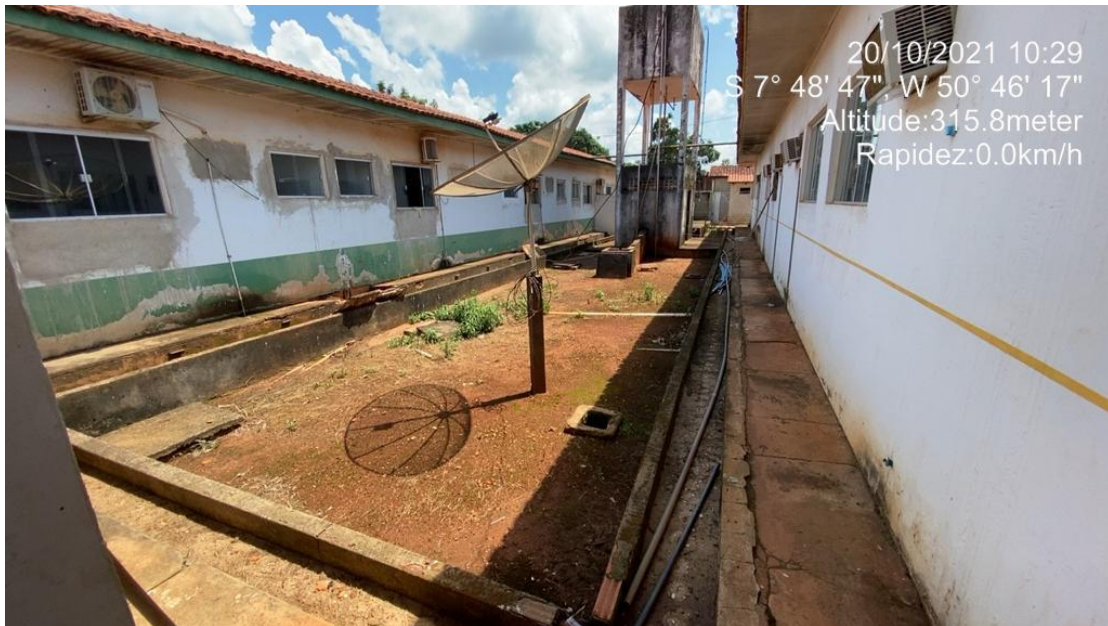
Imagens 38: Alvenaria Reformada, Mas Não Pintada, Infiltração e Umidade.
