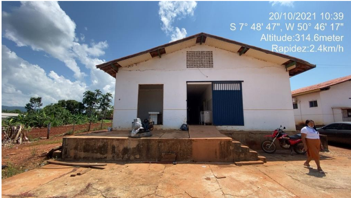
Imagens 54: Forro Beiral Danificado.
