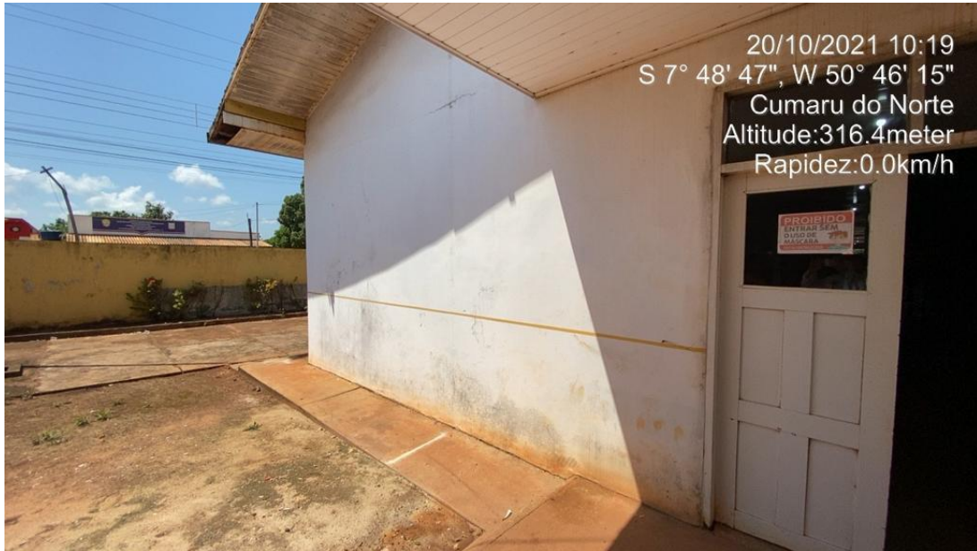
Imagens 20: Infiltração e Umidade na Parede.
