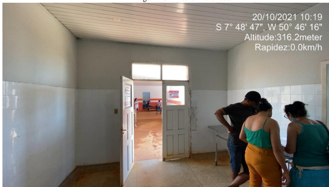
Imagem 17: Deslocamento de Revestimento Cerâmico.
