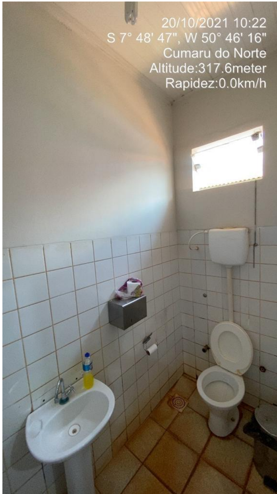
Imagens 29: Piso Manchado.
