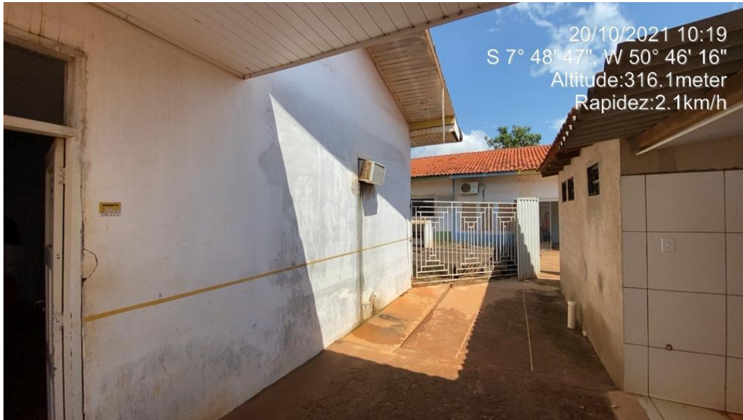
Imagem 18: Infiltração e Umidade na Parede.
