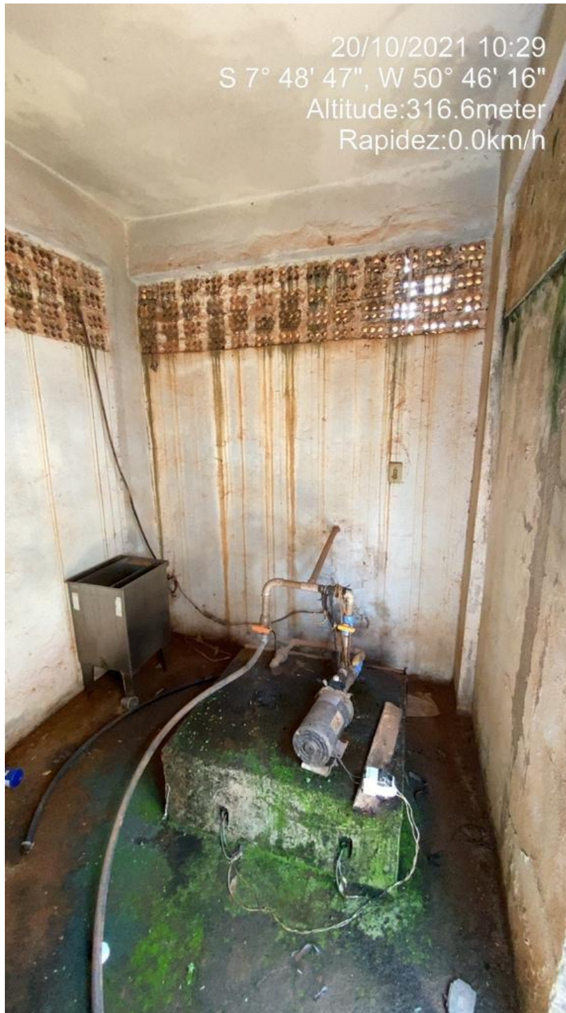
Imagens 40: Casa de Máquinas.
