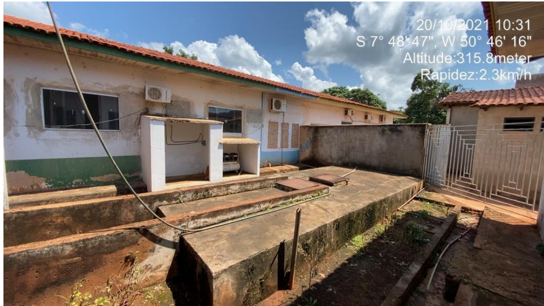
Imagens 41: Alvenaria Reformada, Mas Não Pintada, Infiltração e Umidade.
