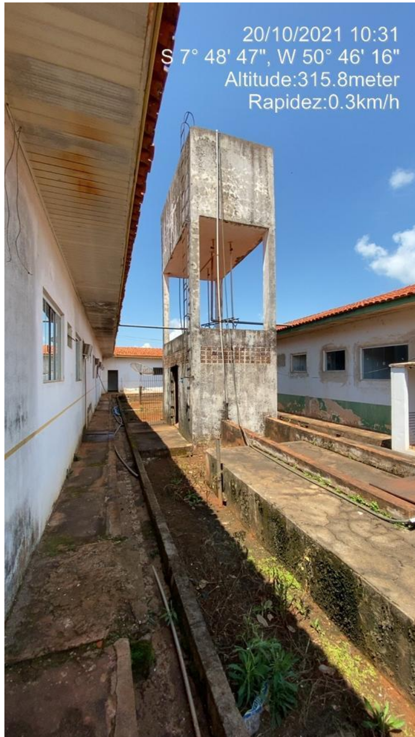
Imagens 42: Alvenaria Reformada, Mas Não Pintada, Infiltração e Umidade.
