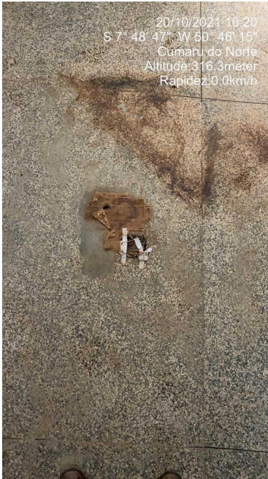
Imagens 22: Piso Danificado.
