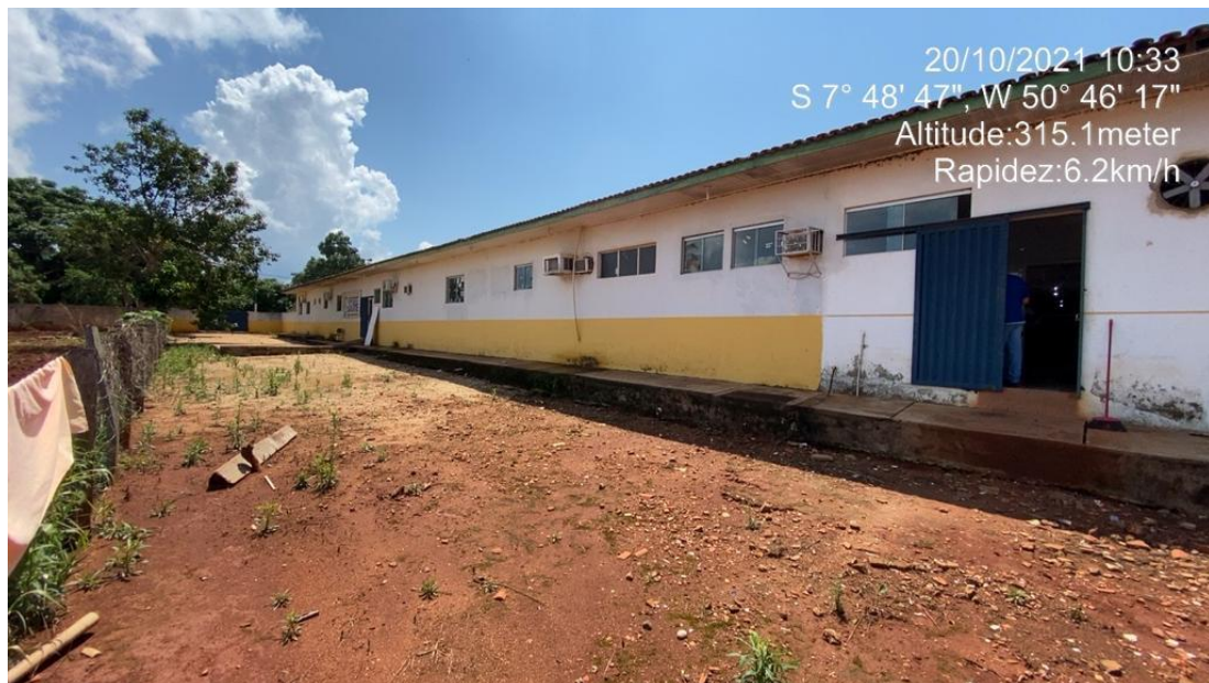
Imagens 48: Parede Com Infiltração e Umidade.
