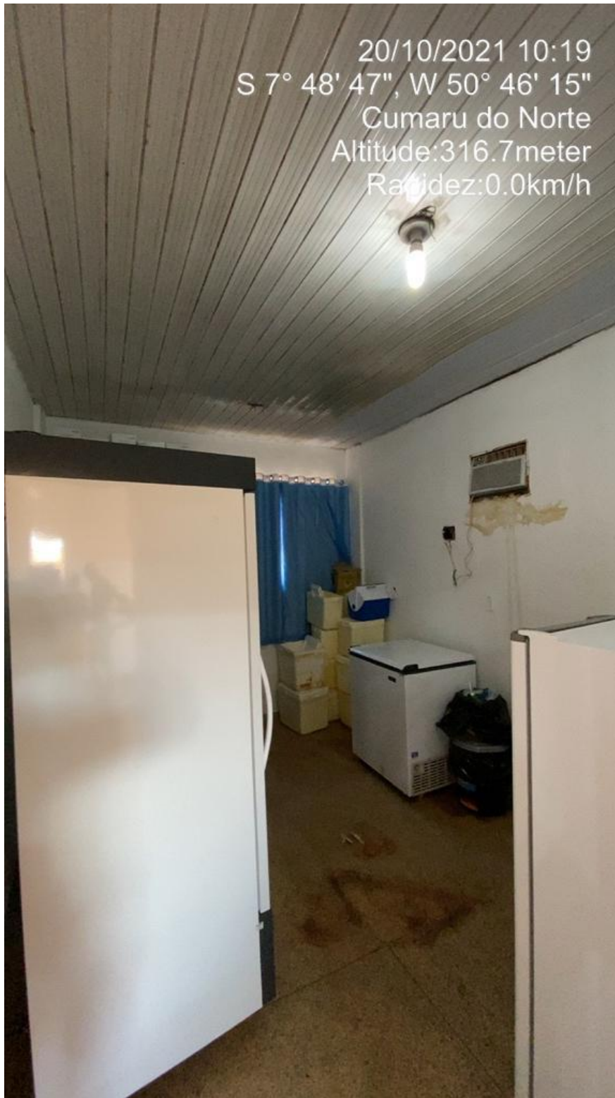
Imagens 21: Machada no Piso, Parede e Forro, e Piso danificado.
