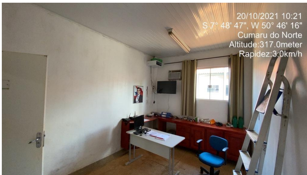
Imagens 28: Pintura Danificada.
