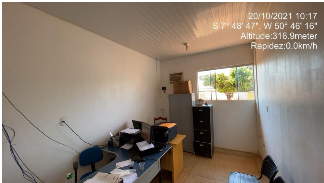
Imagens 11: Pintura danificada.
