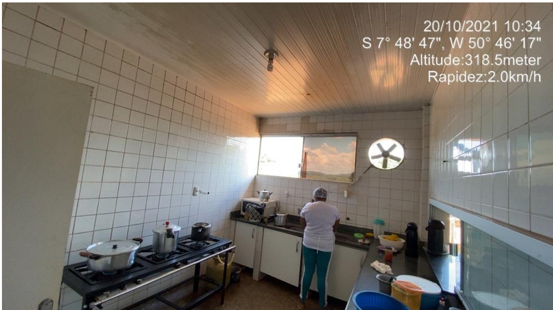
Imagens 52: Deslocamento de Revestimento Cerâmico.
