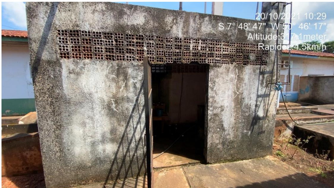
Imagens 39: Casa de Máquinas.
