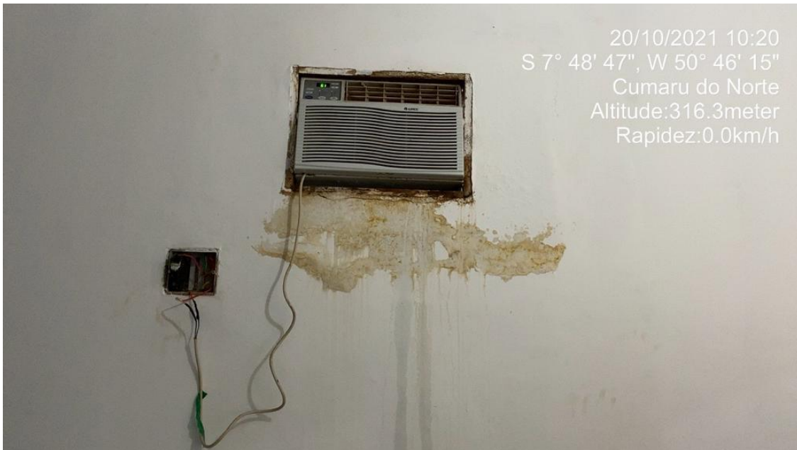
Imagens 23: Mancha na Pintura e Mal Instalação na Fiação do Ar-Condicionado.
