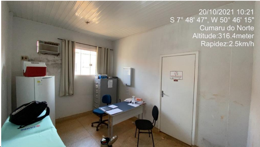
Imagens 26: Pintura Infiltração.
