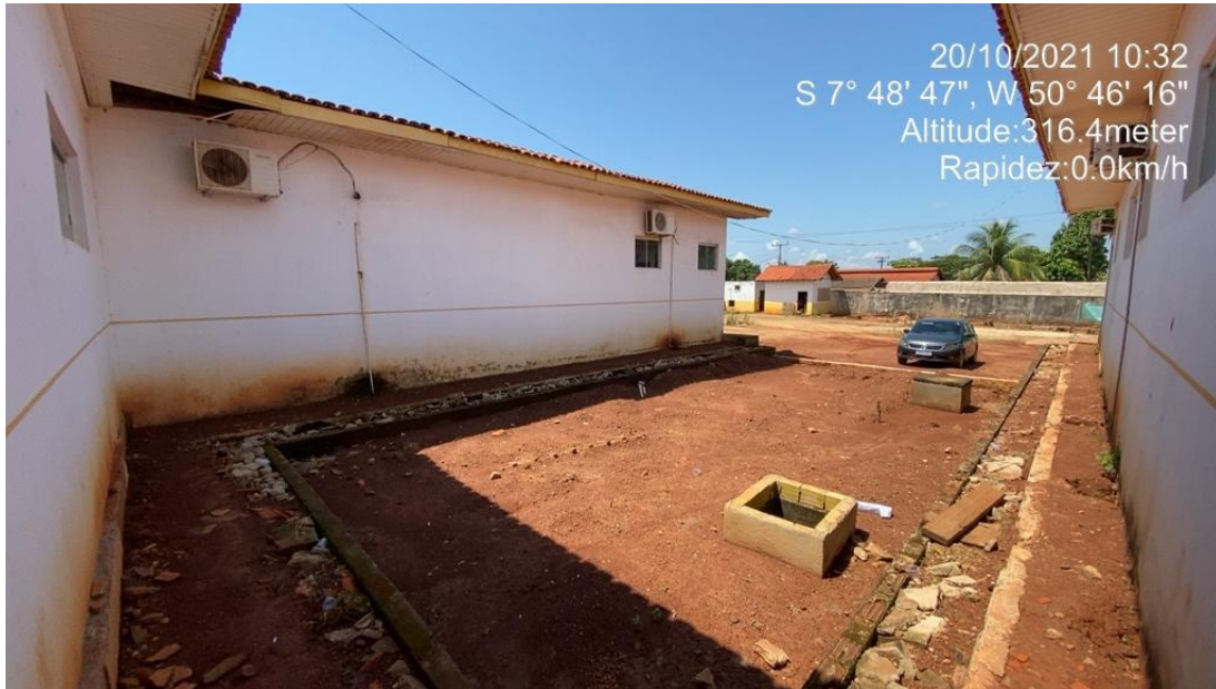
Imagens 45: Calçada Danificada, Infiltração e Umidade na parede, Forro Danificados.
