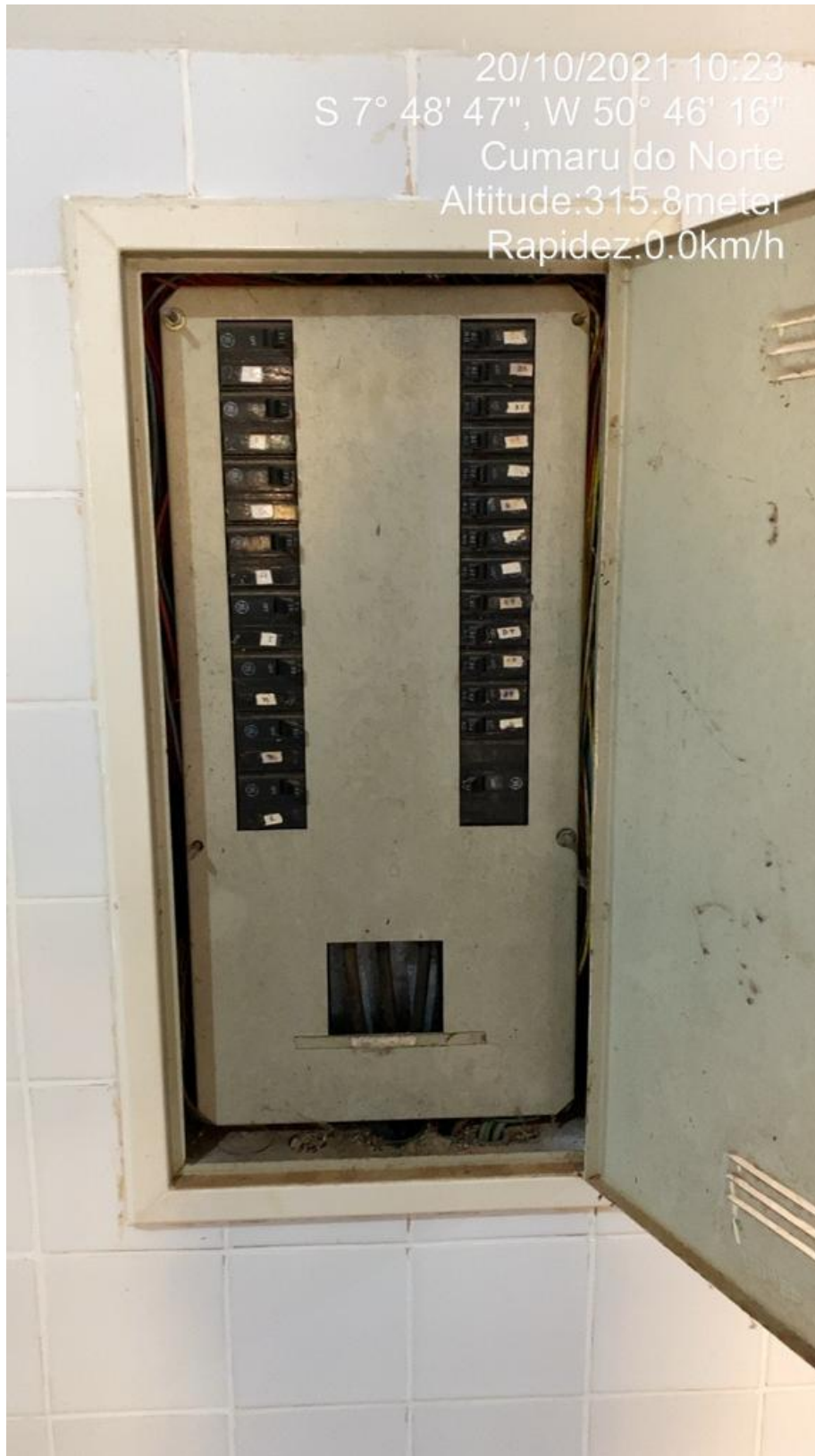
Imagens 31: Quadro de Distribuição.
