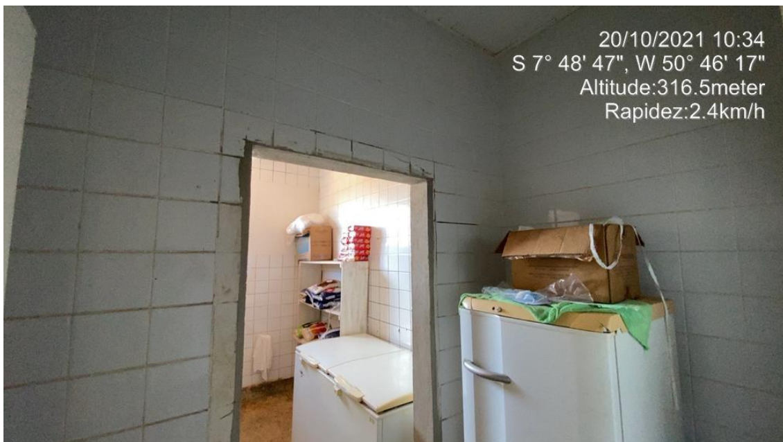
Imagens 53: Deslocamento de Revestimento Cerâmico.
