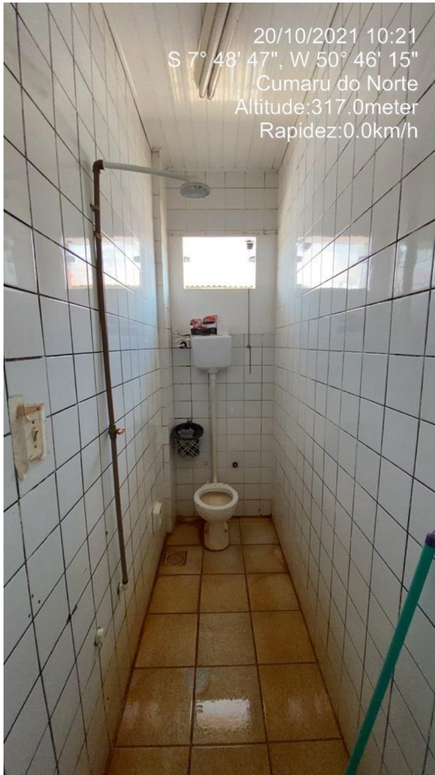
Imagens 25: Banheiro com Piso Manchado e Umidade no rejunte do Revestimento Cerâmico.
