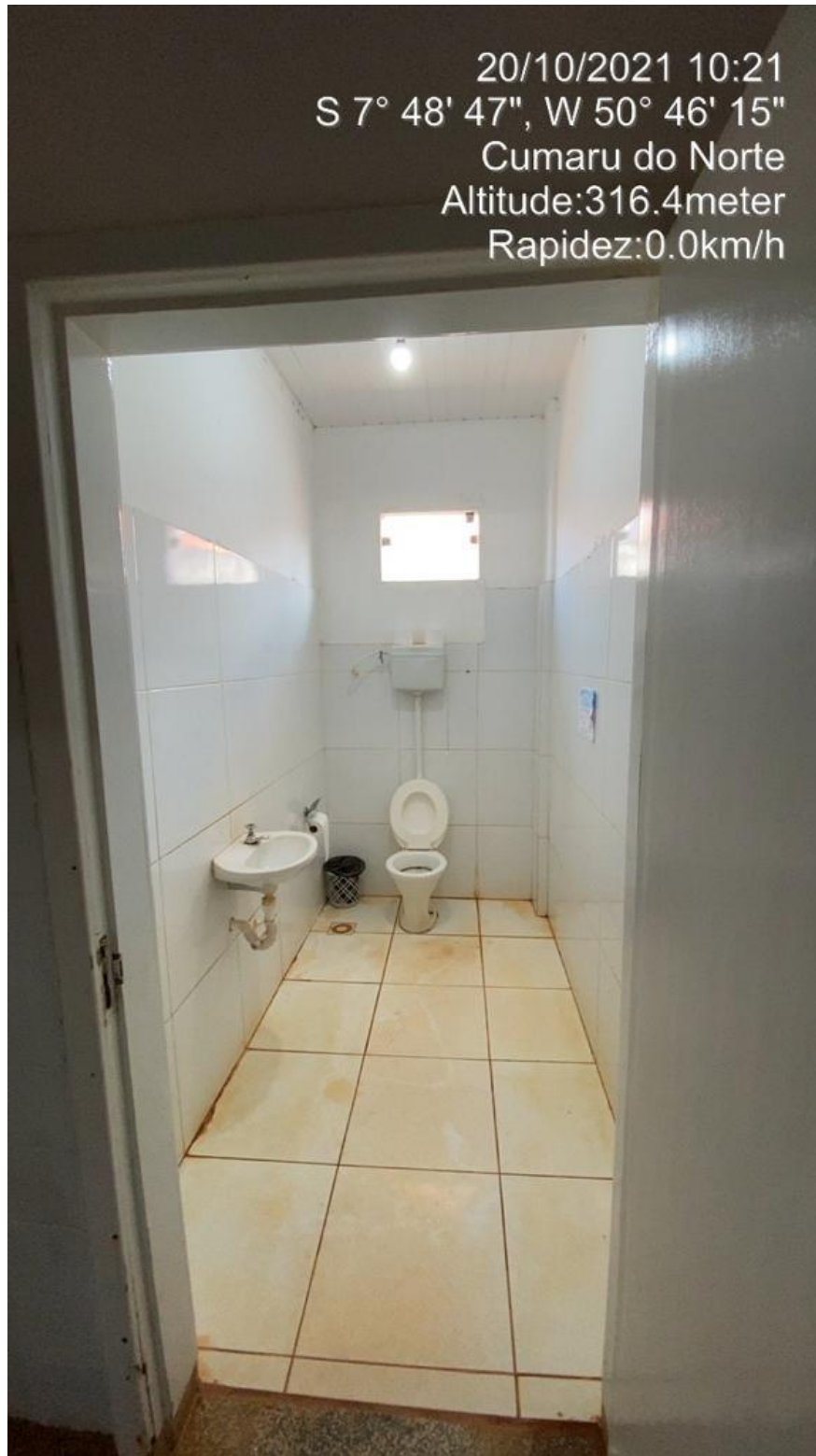
Imagens 27: Piso Manchado.
