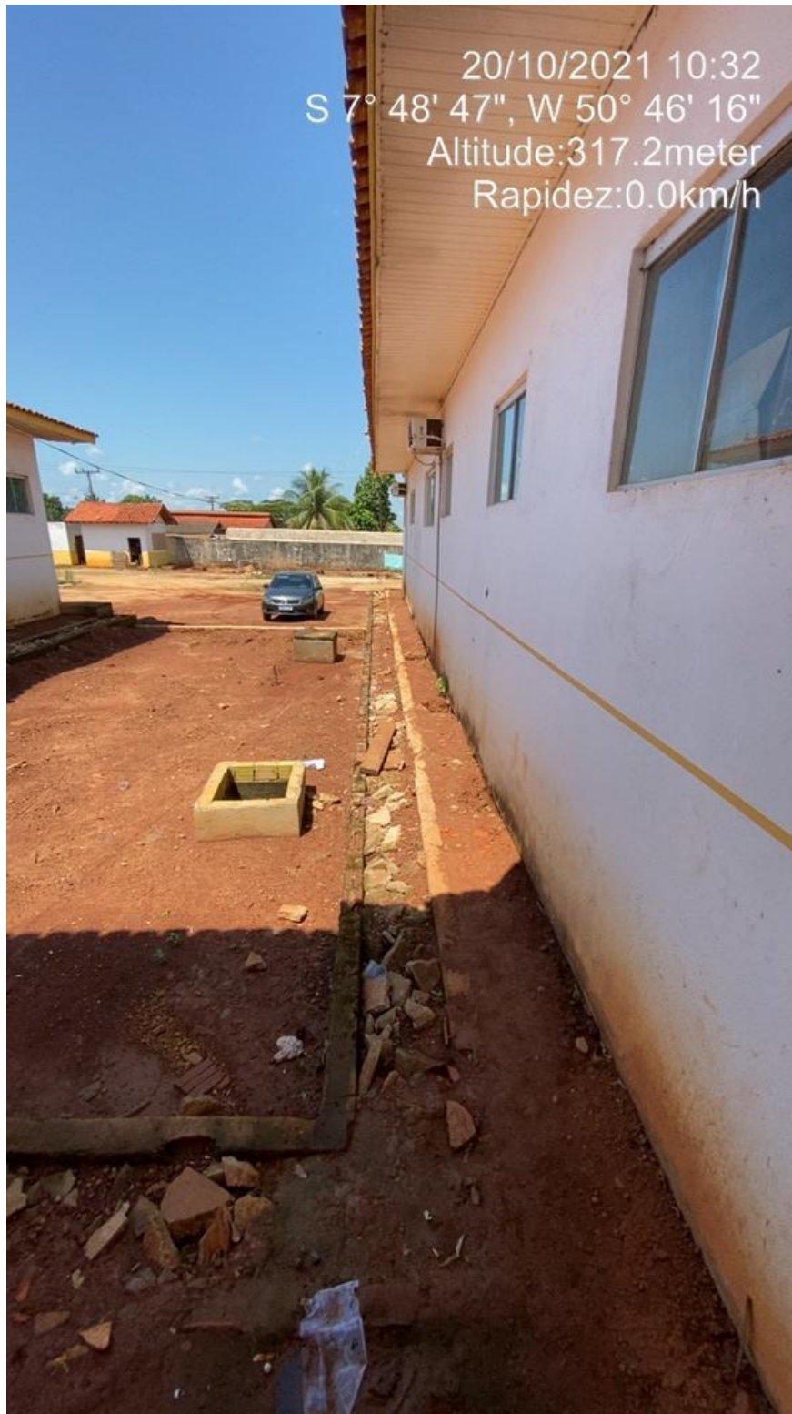
Imagens 44: Falta Calçada.
