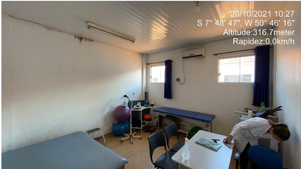
Imagens 36: Infiltração no Forro.
