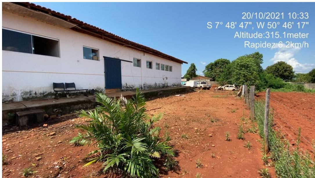
Imagens 50: Parede Com Infiltração e Umidade, Forro Beiral Danificado.
