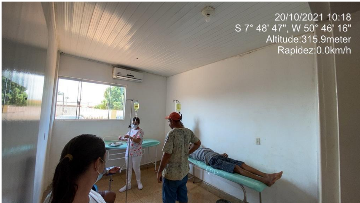
Imagem 14: Pintura Danificada Próximo ao Forro.
