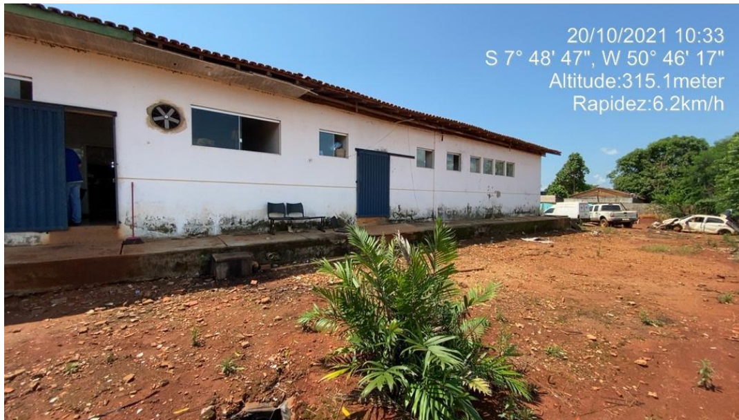
Imagens 49: Parede Com Infiltração e Umidade, Forro Beiral Danificado.
