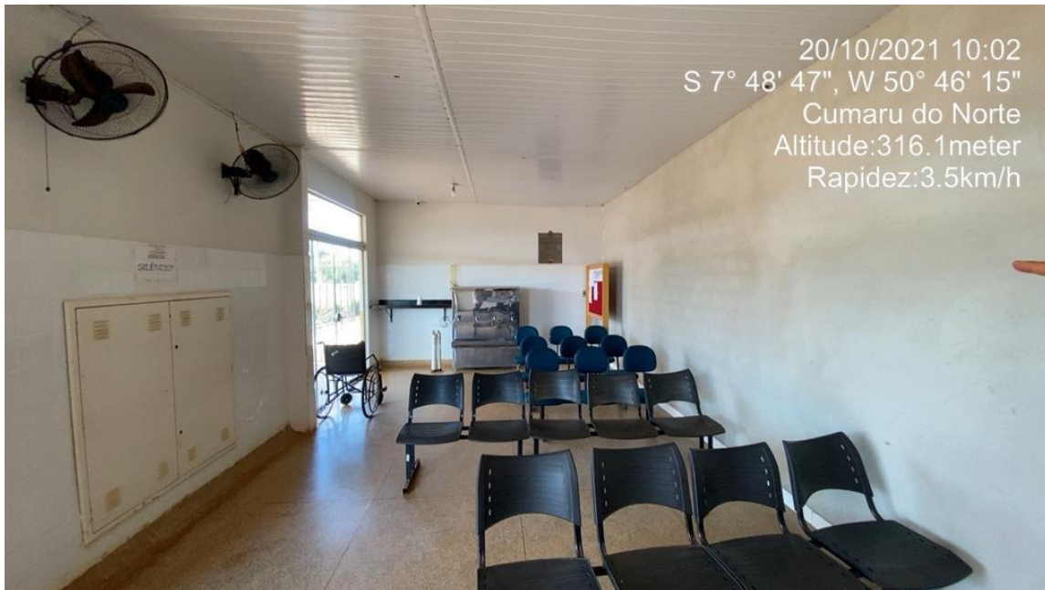
Imagens 04: Sala de Espera Parede S/ Pintura.
